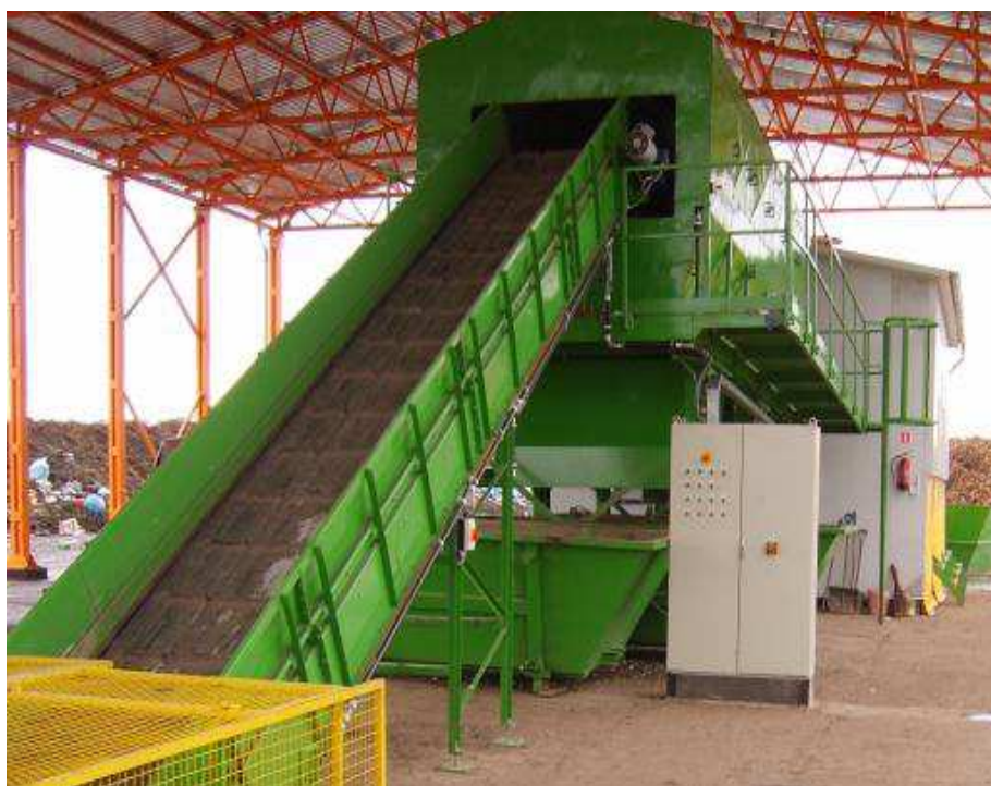
Ryc. 10 Gminna sortownia odpadów zlokalizowana w hali typu szkieletowego z zadaszoną sortownią mechaniczno - ręczną: www.tugeb-polbud.com.pl
